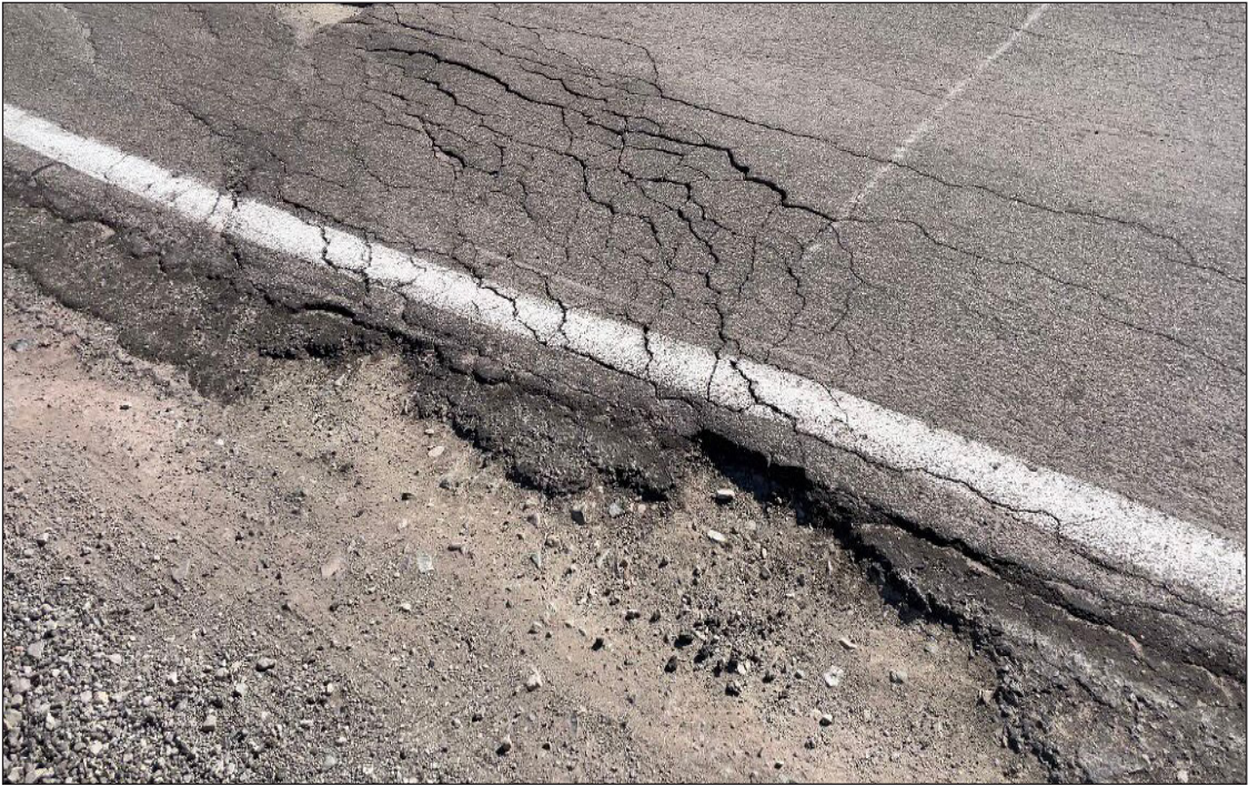
Esta situación que aqueja a la única vía entre Alto del Carmen y Vallenar, se ha estado analizando desde que las grietas aparecieron en el lugar hasta la fecha, con profesionales de SERNAGEOMIN y Vialidad
