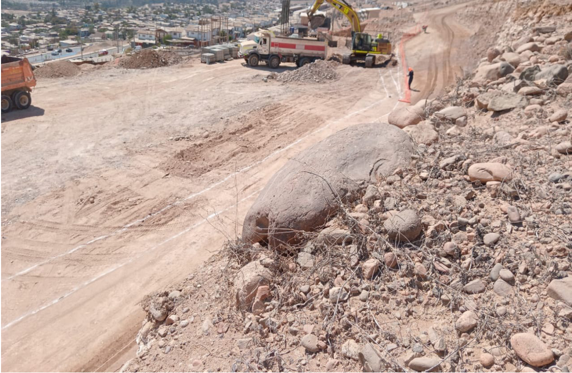
El informe señala que “en consideración del riesgo inminente en que se encuentra uno de los bloques de arte rupestre producto de las excavaciones asociadas al camino, se solicita la implementación del salvataje del bloque.
