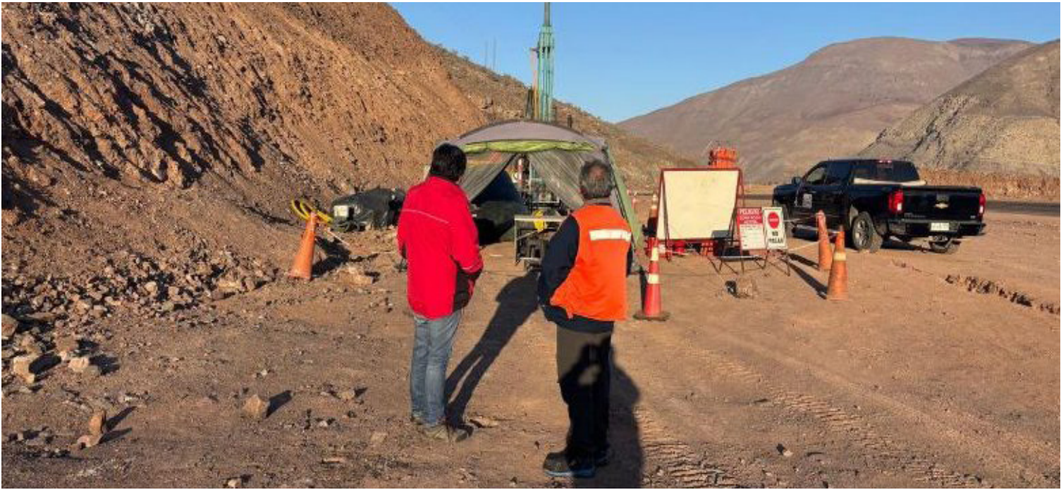
Este estudio surge a raíz de la detección de grietas en la calzada y zonas aledañas al camino, entre los kilómetros 28,400 y 28,620, lo que representa un riesgo para la seguridad de los usuarios y la infraestructura vial.
