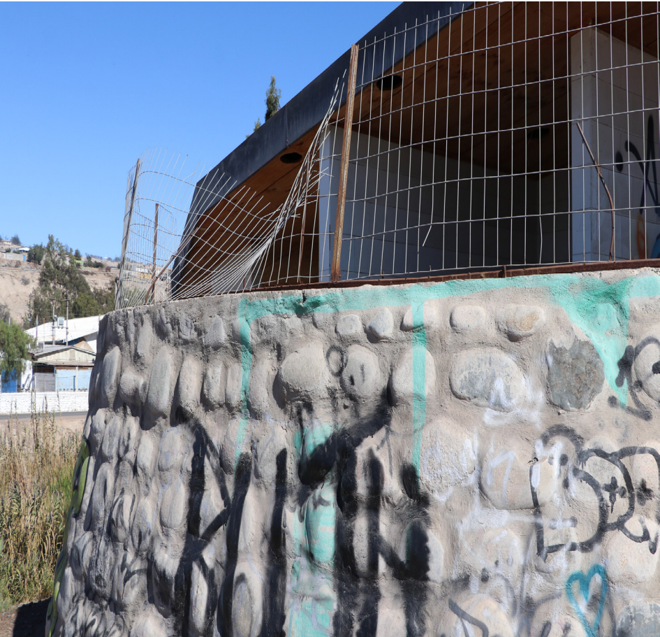
Los baños del sector están vandalizados
