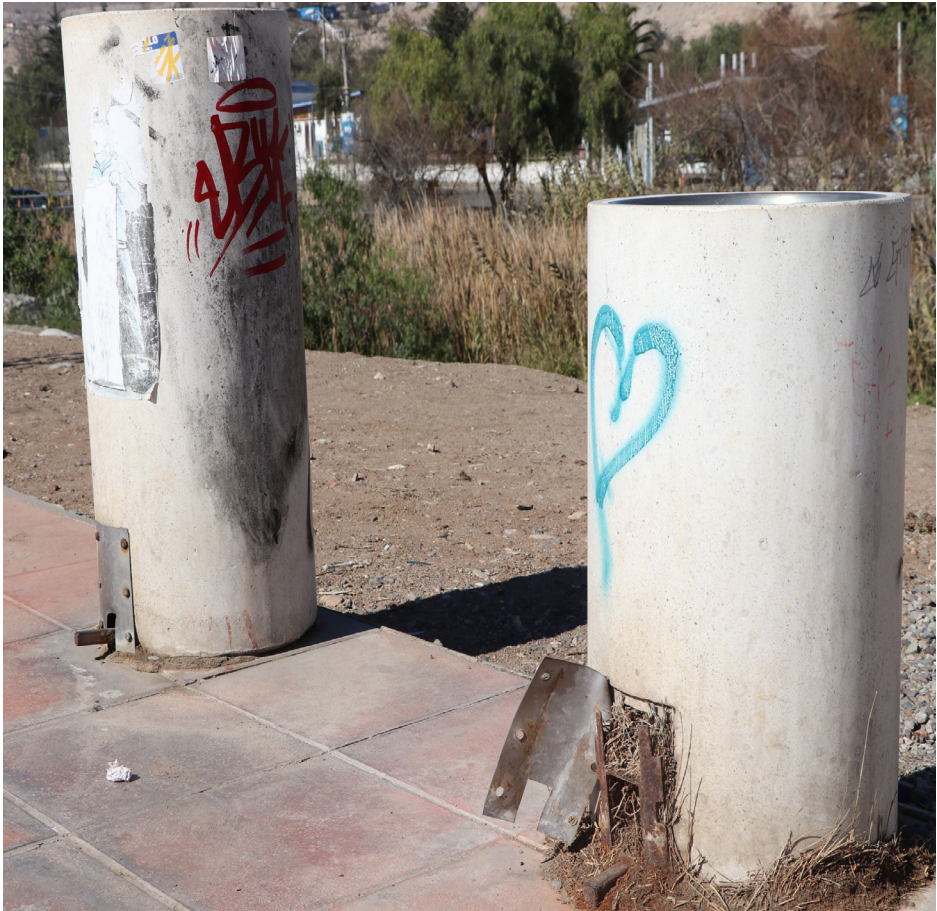
La destrucción y abandono del lugar es evidente.
