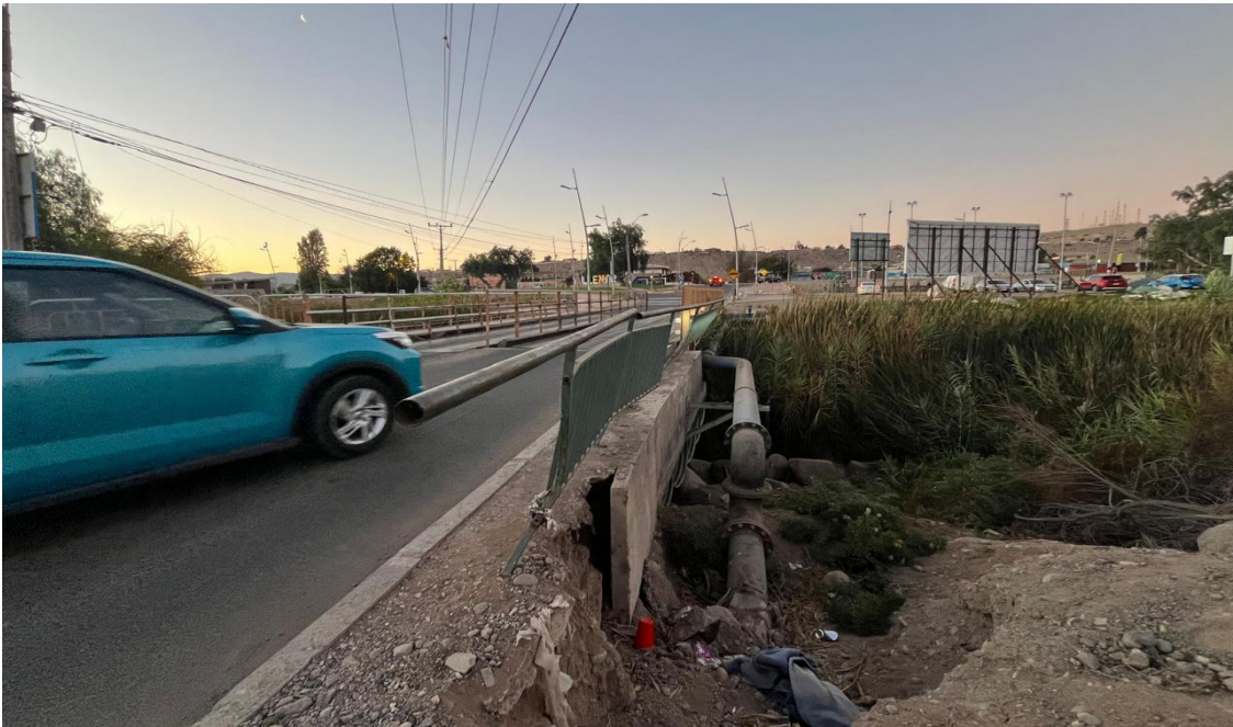
Un puente peligroso, deteriorado, en mal estado, sin mantención. Se espera que en diciembre comiencen los trabajos de remodelación y arreglos.
