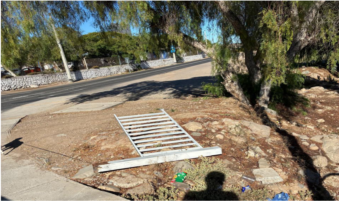
Así amaneció hace algunos días, parte de las rejas de protección del puente Añañuca en población Quinta Valle. Los vecinos se volvieron a manifestar instalando globos y bolsas negras en el lugar. Hasta el momento, no hay respuestas oficiales.
