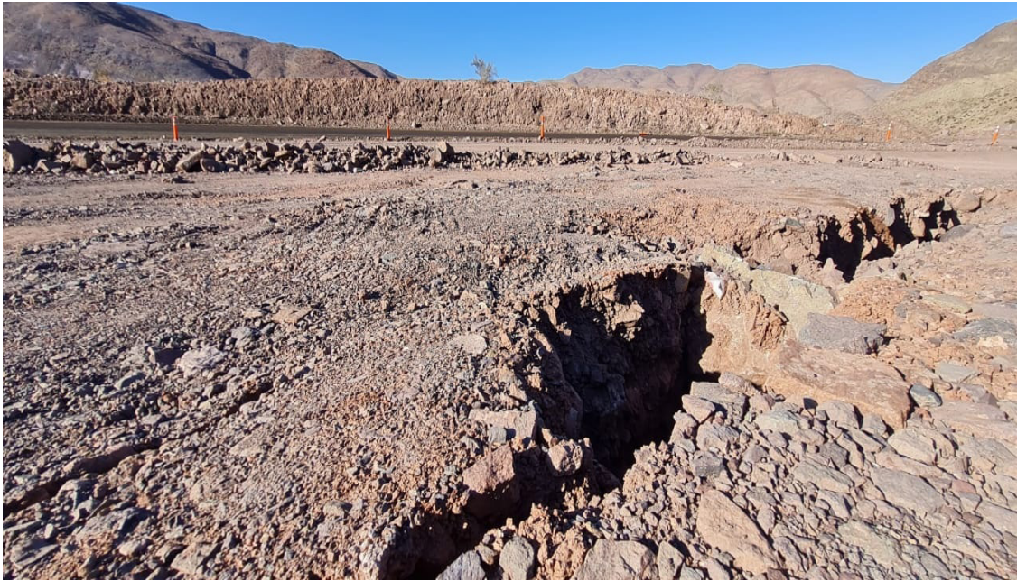
Cabe recordar, que las primeras fisuras, según la Junta de Vigilancia del río Huasco, se detectaron en el año 2021, y a cinco años, el problema persiste.
