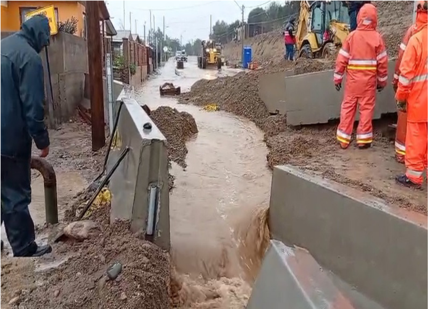
Las precipitaciones registradas en la Provincia del Huasco provocaron anegamientos y escurrimientos en distintos puntos de Huasco y la activación de quebradas en sectores de Freirina. Autoridades mantienen el monitoreo ante la continuidad de las lluvias durante este martes.
