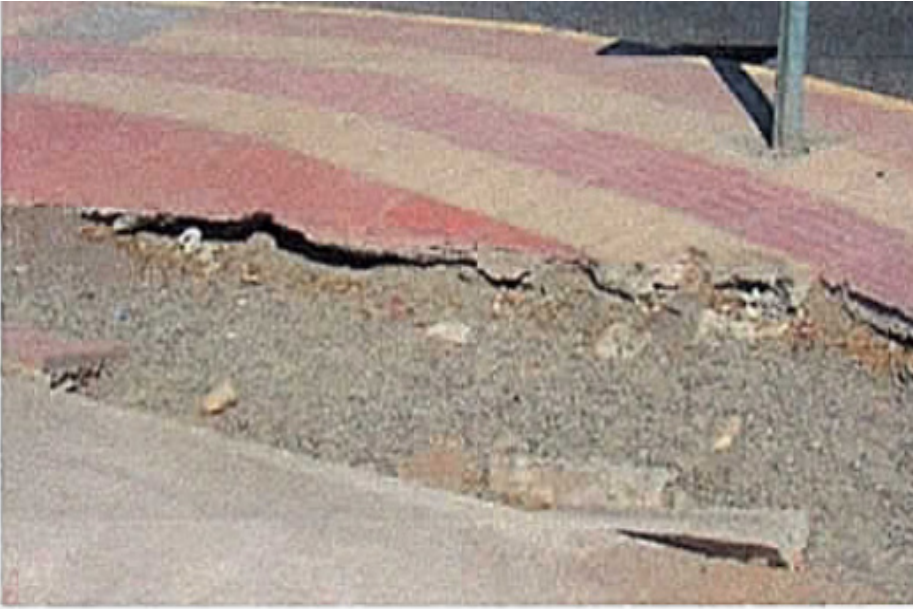
Ilustración 15: Calle añahuca - Av. costanera Norte. Ausencia de reposición de baldosas de manera definitiva en aceras peatonales.
