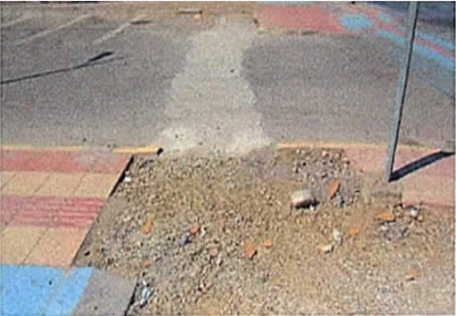
Ilustración 16: Puente Añahuca - Av. Costanera. Ausencia de reposición de baldosas, asfalto y soleras.
