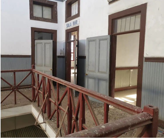
LAS FECAS DE PALOMA ACELERAN EL DETERIORO DEL EDIFICIO
